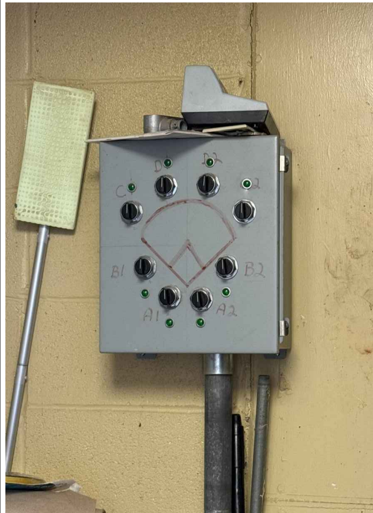
4 EXISTING LIGHTING CONTROLLER SCALE: N.T.S.
